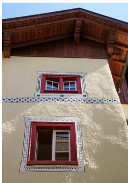
Städtlistrasse, Illanz, Keim'sche Silikattechnik, Soldalit-Anstrich, 4-jährig
